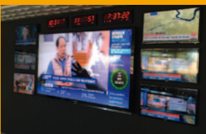
SERVICIOS GENERADOS por un equipo de Moduladores T.OX en los estudios de "Weather Nation TV" en Greenwood Village - Colorado (USA)
